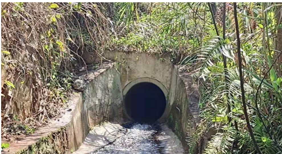
图 4.2-1 废水排放口照片
