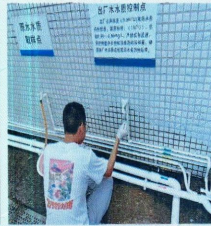
东升水厂（出厂水）
