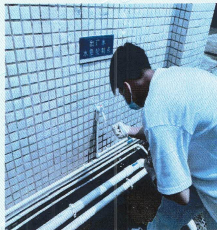
东升水厂（出厂水）
