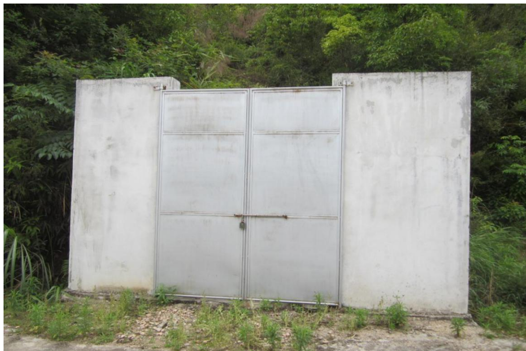
照片 2-16 ZK1 井防护房(镜头向北西)
