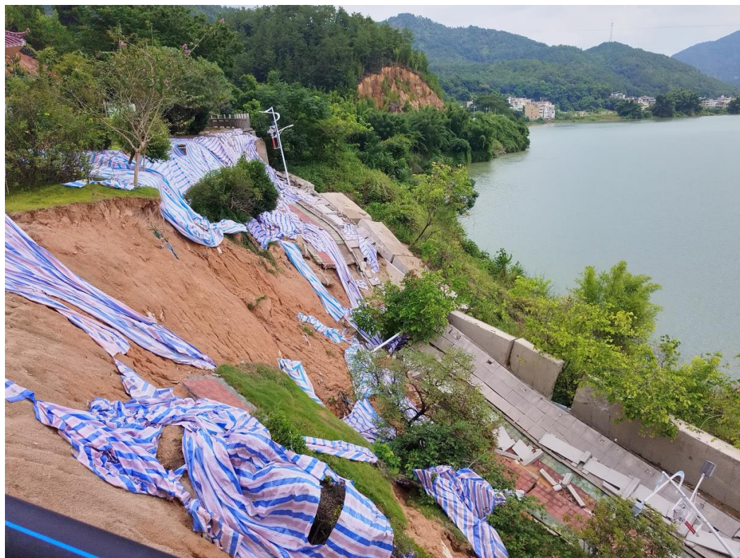
图 3.2-4 潭江镇韩江右岸堤防滑坡现状图
