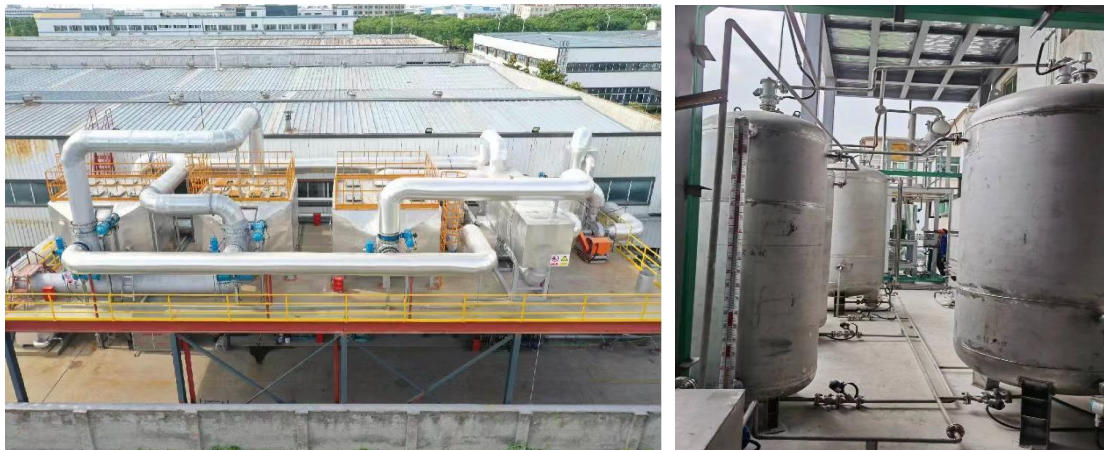
图 7.2-4 相同冷凝废气处理工艺实例图
