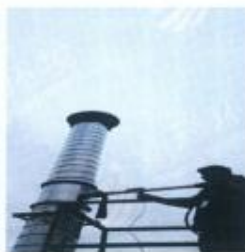
FQ-00003 废气排放口
