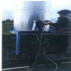
锅炉废气排放口
