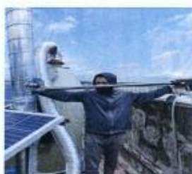
有机废气排放口
