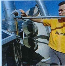
有机废气排放口
