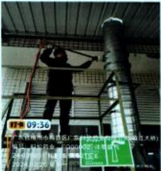
H线注塑废气排放口FQ00002
