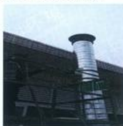
FQ-00002 废气排放口
