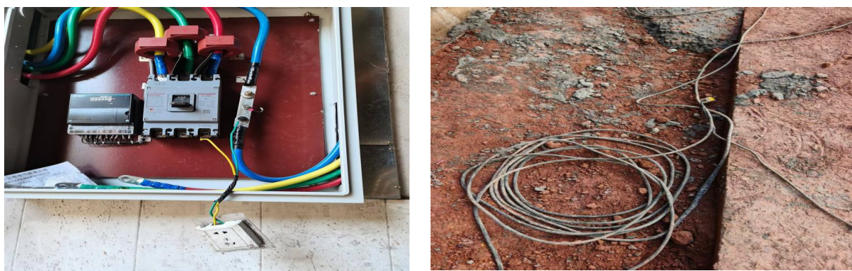
图二 取电电箱和插座、取电电缆
