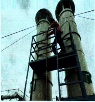
DA008 废气处理后采样口
