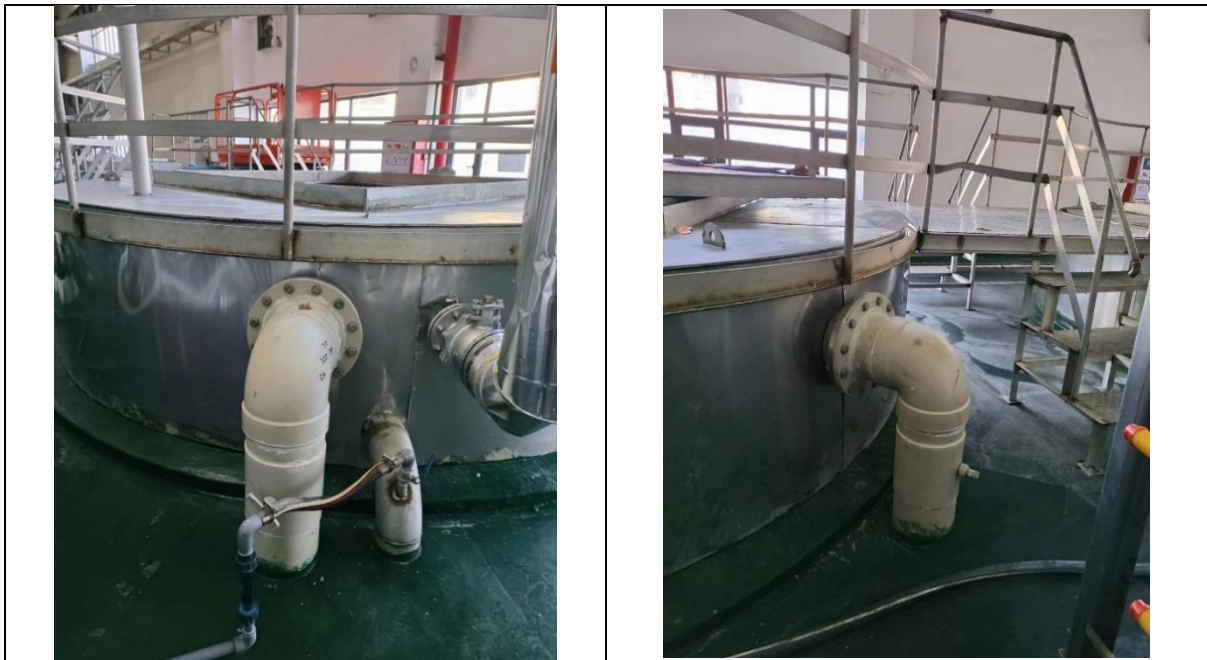
溶铜罐密闭及废气收集管道
