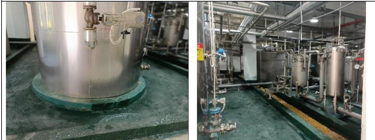
溶铜罐防腐蚀及围堰、收集渠
