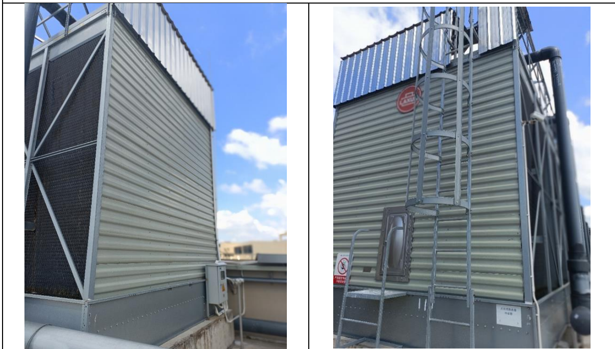
楼顶冷却塔隔声板
