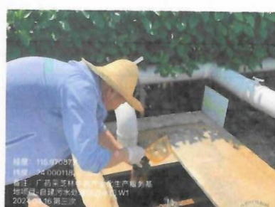
W1 自建污水处理站进水口：第三次
