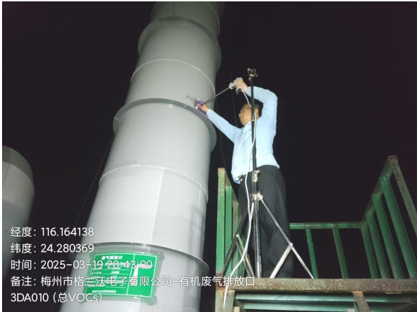
有机废气排放口 3 DA010 : 总 VOCs
