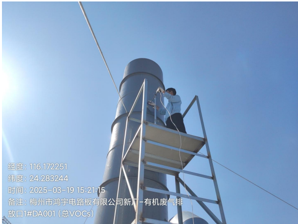
有机废气排放口 1#DA001：总 VOCs
