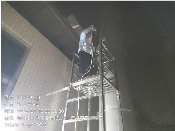
有机废气排放口 3#DA014: 总 VOCs
