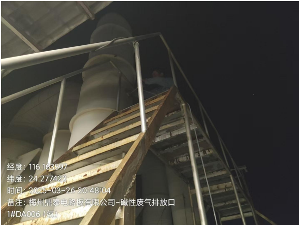
碱性废气排放口 1#DA006：氨
