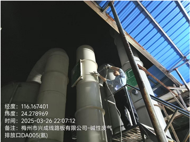
碱性废气排放口 1#DA005：氨
