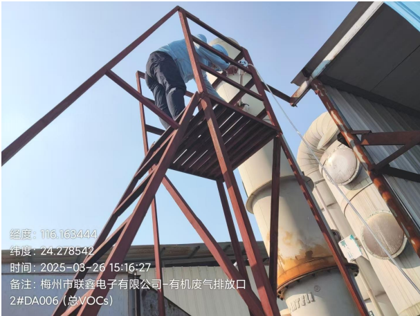
有机废气排放口 2#DA006：总 VOCs
