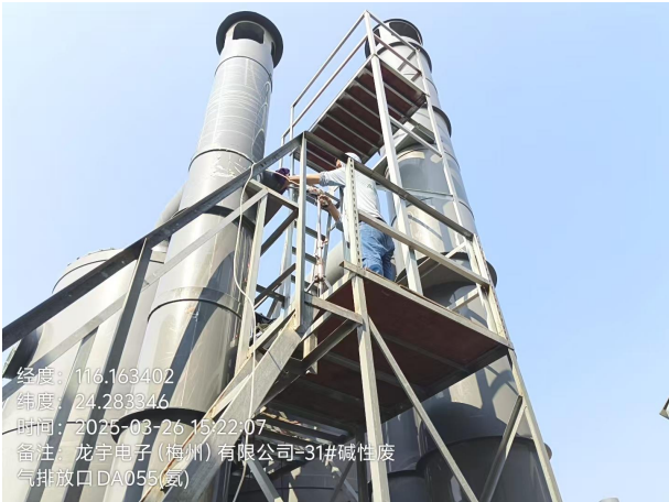
31#碱性废气排放口 DA055：氨
