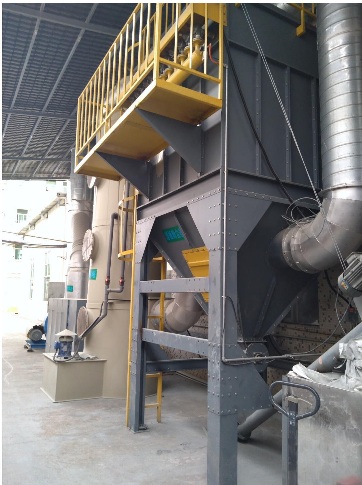
图 2.1-18 废电路板破碎分选废气处理系统实装图
