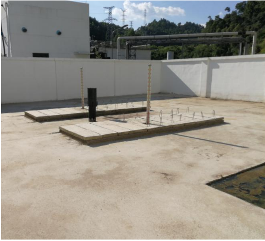
地埋式柴油罐
